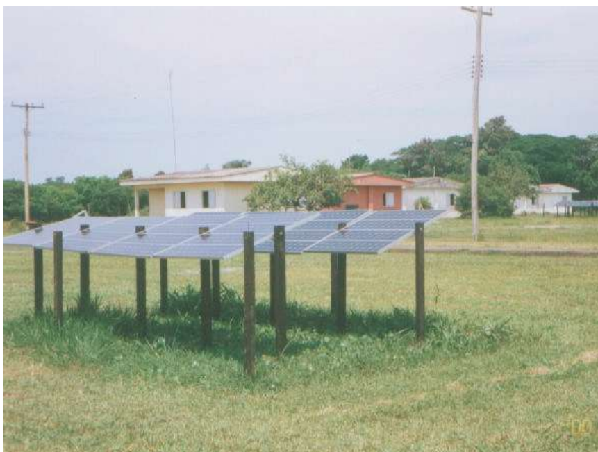
Figura 4.7. Instalação fotovoltaica do “Núcleo Perequê”.
